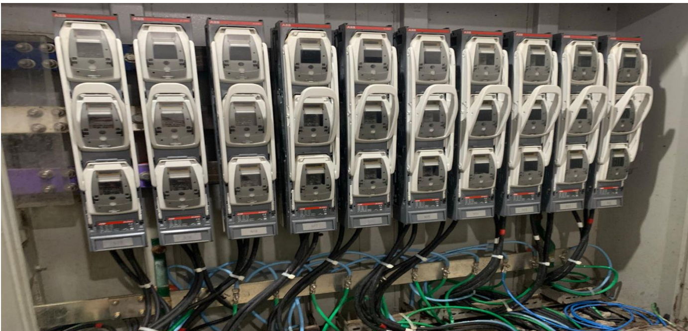
Foto 05: Vista Interna / Quadro de Força
