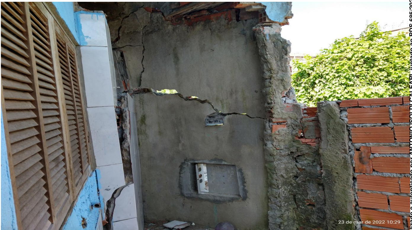
FC.SM-14-03.3: Vista do setor: observar a presença de rachadura em parede de alvenaria.
