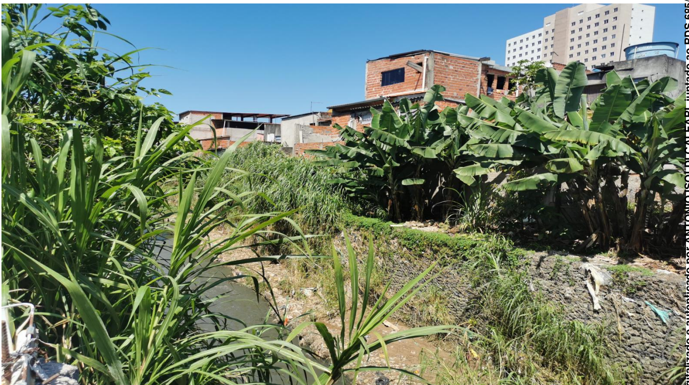
FC.SM-14-01.2 Vista geral do setor: observar a distância das moradias ao topo do talude.
