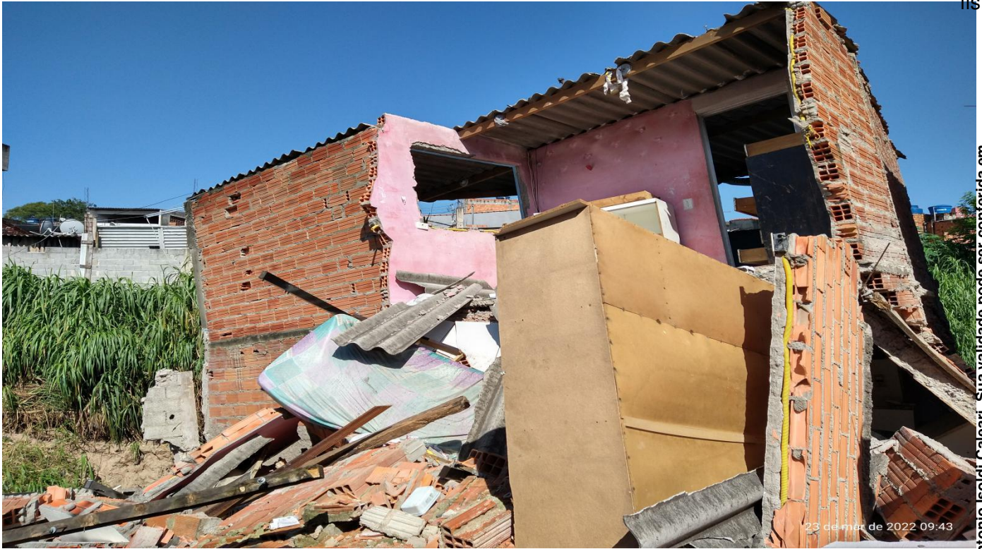
FC.SM-14-03.2: Vista do setor: observar o tombamento de edificação.
