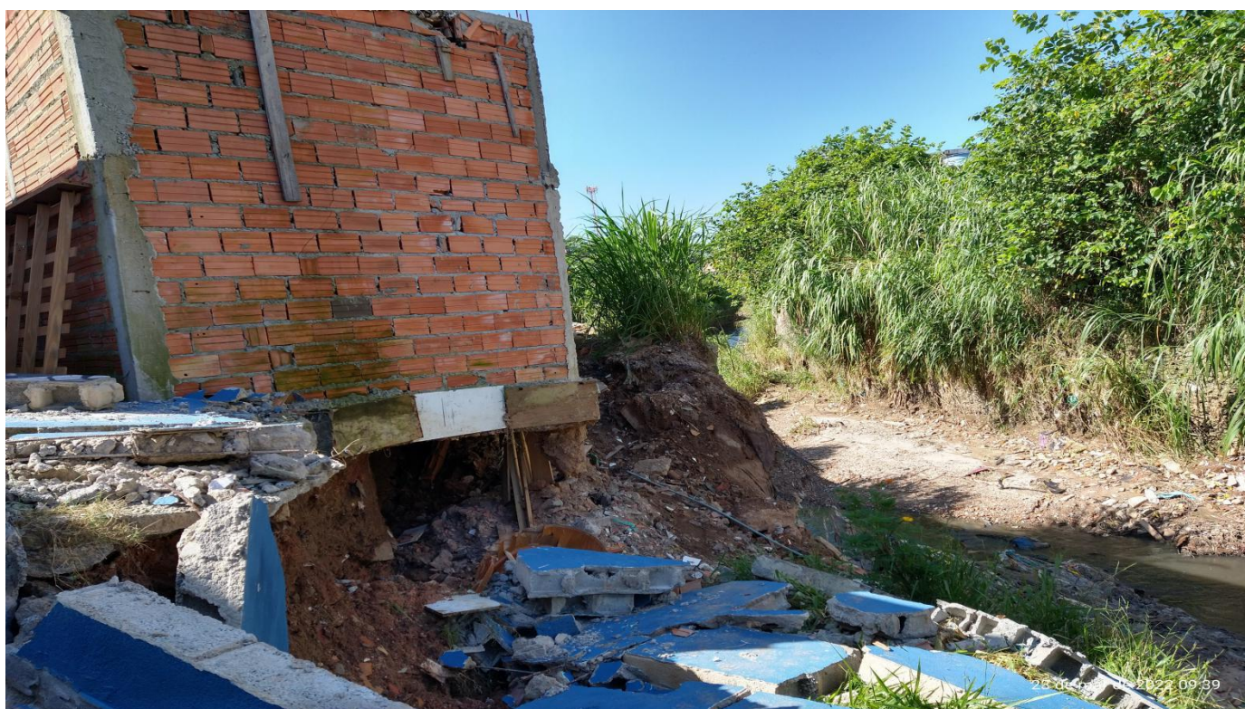
FC.SM-14-03.1: Vista do setor: observar a distância das moradias ao topo do talude.
