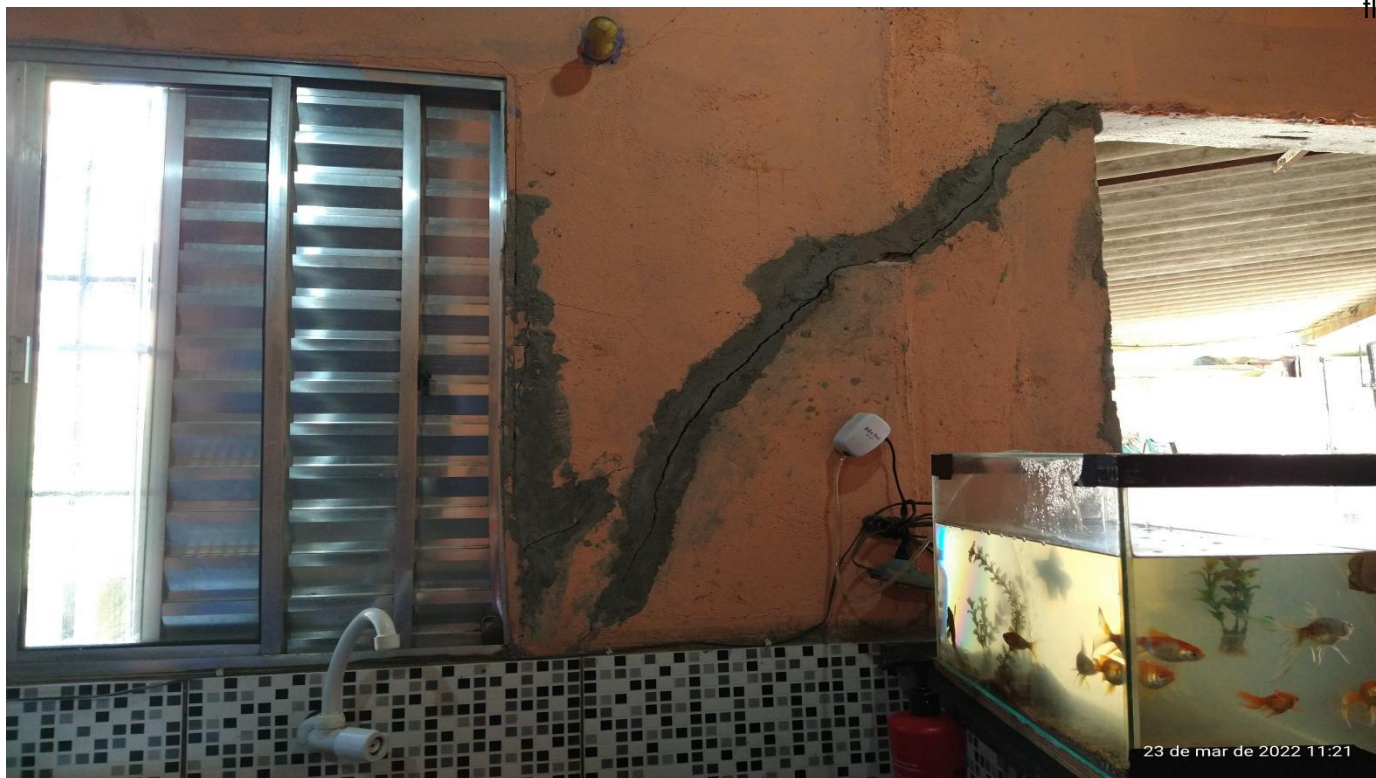
FC.SM-14-02.3: Vista do setor: observar a presença de rachaduras em parede.
