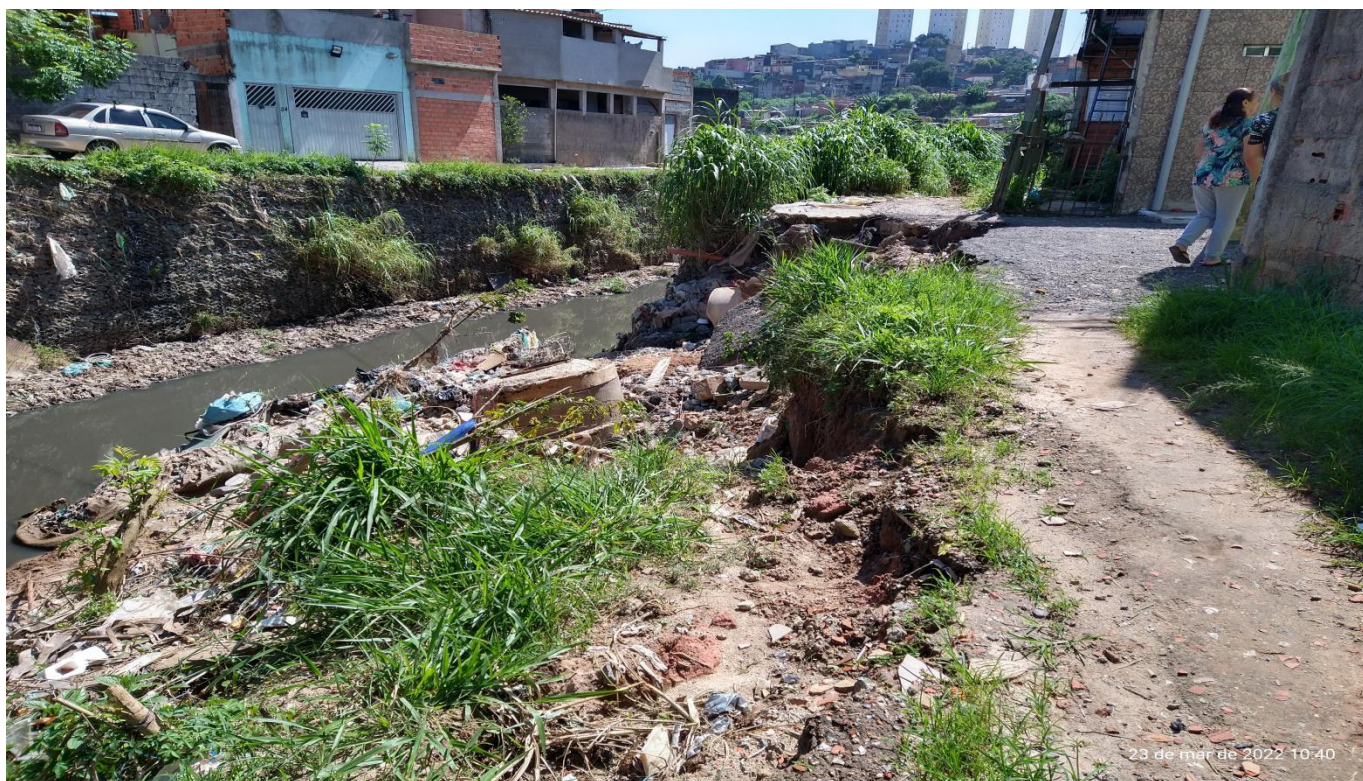
FC.SM-14-02.2: Vista do setor: observar a ruptura do sistema de drenagem.
