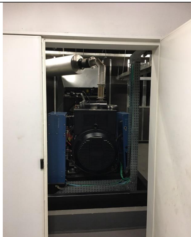
Foto 2 – Entrada Cabine do Gerador
