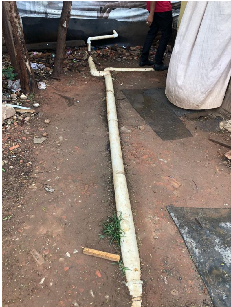
Imagem 15 – Rede clandestina de esgoto
