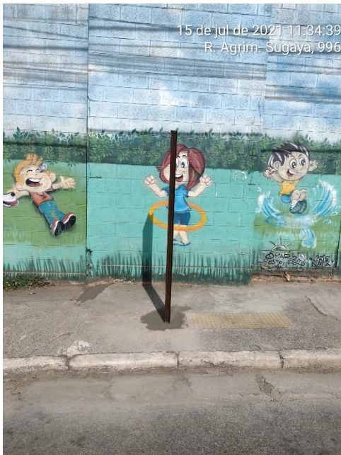
Foto 14: Vista lateral do novo equipamento instalado no local.
