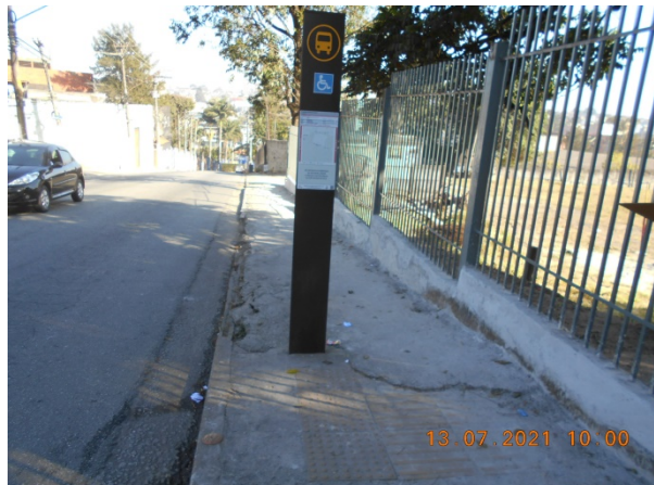
TOTEM MARROM – ALT. 288 (OP) B/C ANÁLISE TÉCNICA: Executar limpeza.
