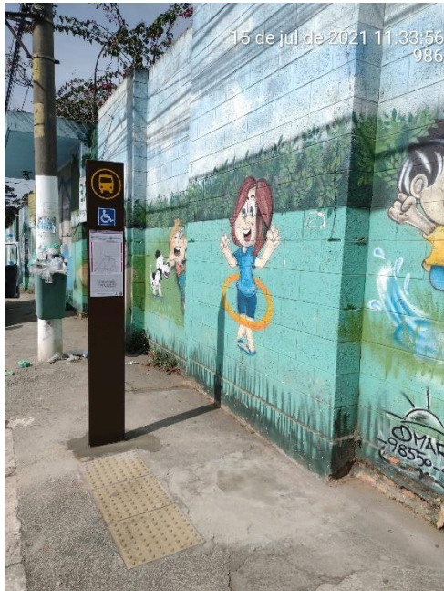
Foto 13: Visão geral do novo equipamento instalado no local.
