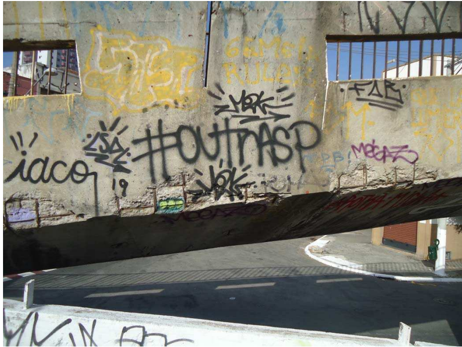
FOTO 15 – Armaduras expostas nas vigas-rampas no lado Rua Capistrano de Abreu.
