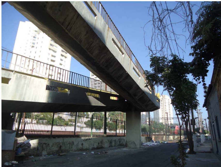
FOTO 2 – Vista da rampa lado Rua Luigi Greco. Notar pilar danificado.
