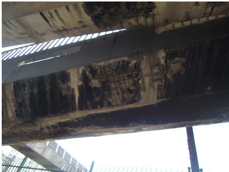
FOTO 6 – Detalhe das vigas-rampas atingidas pelo fogo no lado da rampa Rua Luigi Greco
