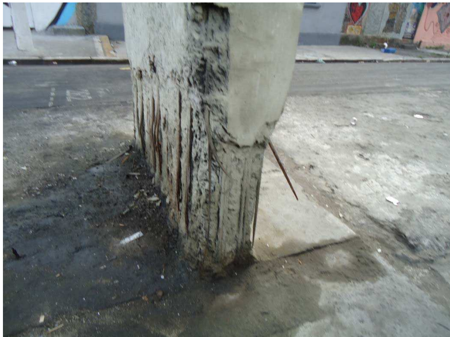
FOTO 10 – Mesmo pilar anterior. Notar os danos na armadura.
