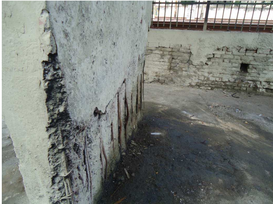
FOTO 9 – Mesmo pilar anterior. Notar as barras flambadas da armadura longitudinal.
