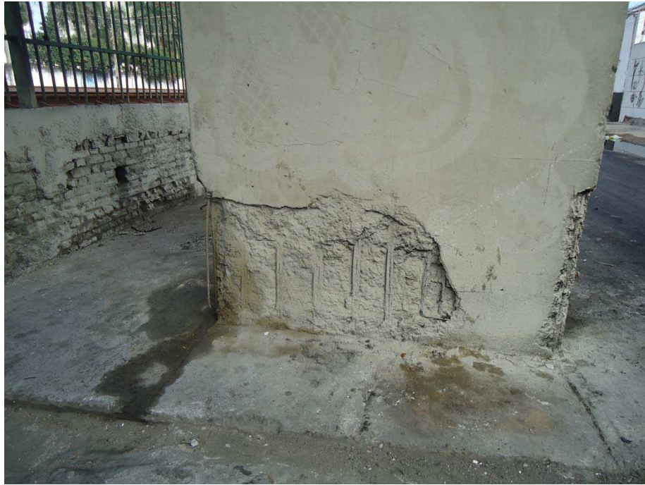
FOTO 7 – Uma das faces do pilar que apoia as vigas-rampas atingido pelo fogo no lado Rua Luigi Greco.
