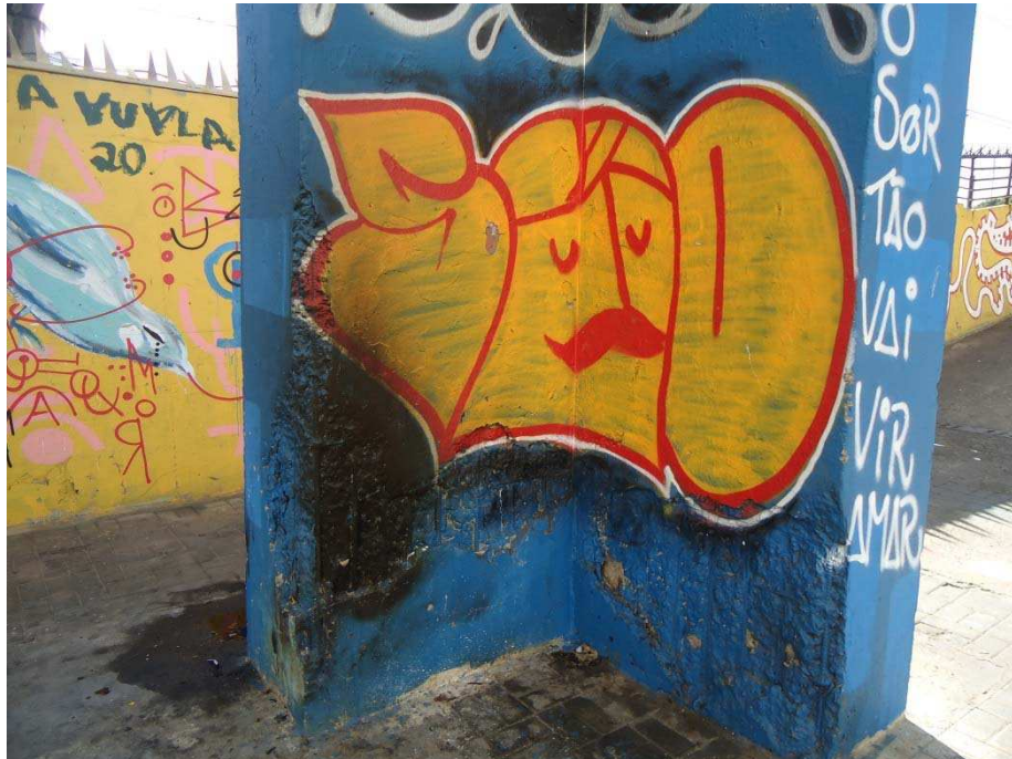
FOTO 16 – Pilar em "L" no lado Rua Capistrano de Abreu com armaduras expostas.
