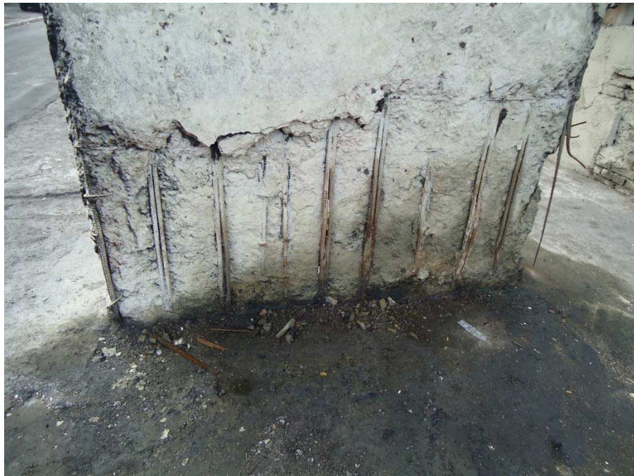
FOTO 8 – Face oposta do pilar que apoia as vigas-rampas atingido pelo fogo no lado Rua Luigi Greco. Notar a ausência de estribos.
