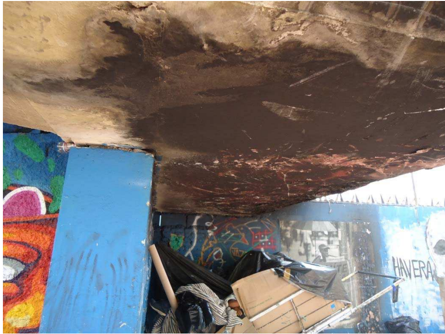
FOTO 17 – Fuligem e eflorescências sob a viga-rampa lado Rua Capistrano de Abreu.
