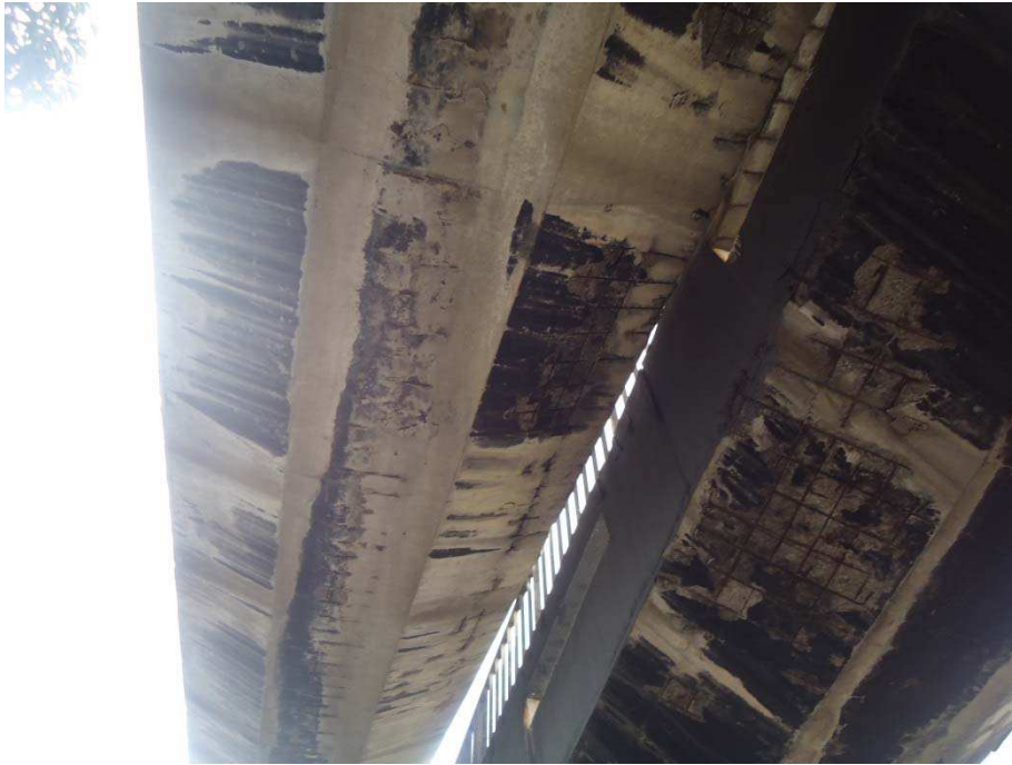
FOTO 5 – Vigas-rampas atingidas pelo fogo no lado da rampa Rua Luigi Greco
