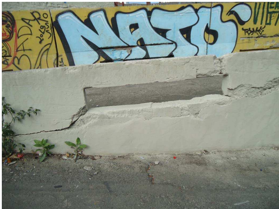
FOTO 4 – Rampa lado Rua Luigi Greco. Guarda-corpo quebrado.
