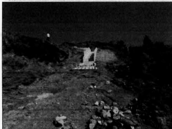
Foto 11 – Escada hidráulica com dissipador de energia instalada na lateral da faixa. Notar a ausência de cobertura vegetal e a ocorrência de processos erosivos.
