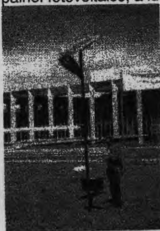
Sistema fotovoltaico autônomo de iluminação. Brasília/DF.
