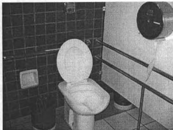
Fig. 36 – Vaso Sanitário (Boxe adaptado- Térreo)
