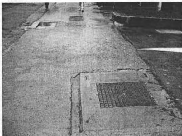
Fig. 63 – Revestimento cimentado danificado do passeio.
