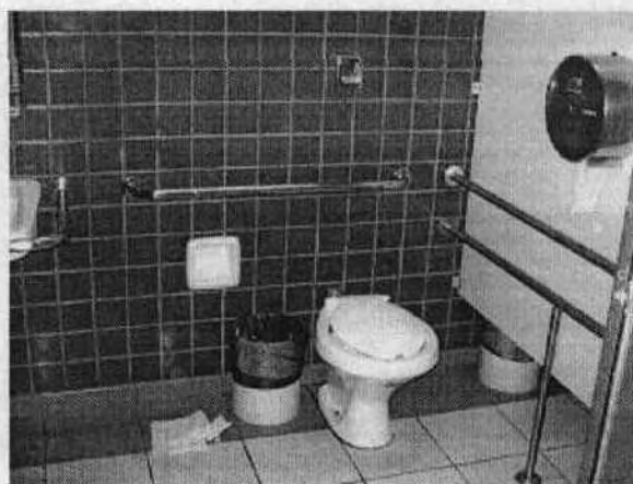
Fig. 10 - Boxe Acessível Piso 2 - Vaso, barras e acessórios.
