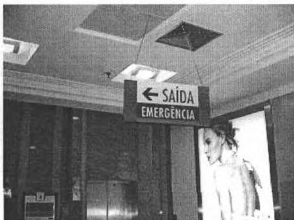
Fig. 72 – Sinalização de emergência
