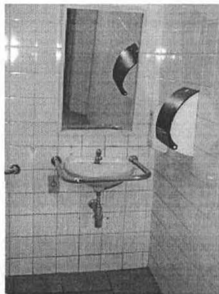
Fig. 5 – Lavatório com barras de apoio.
