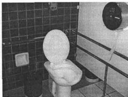
Fig. 16 – Vaso sanitário e barras de apoio.
