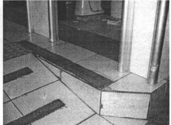
Fig. 32 – Porta do boxé na rampa. Alto risco.
