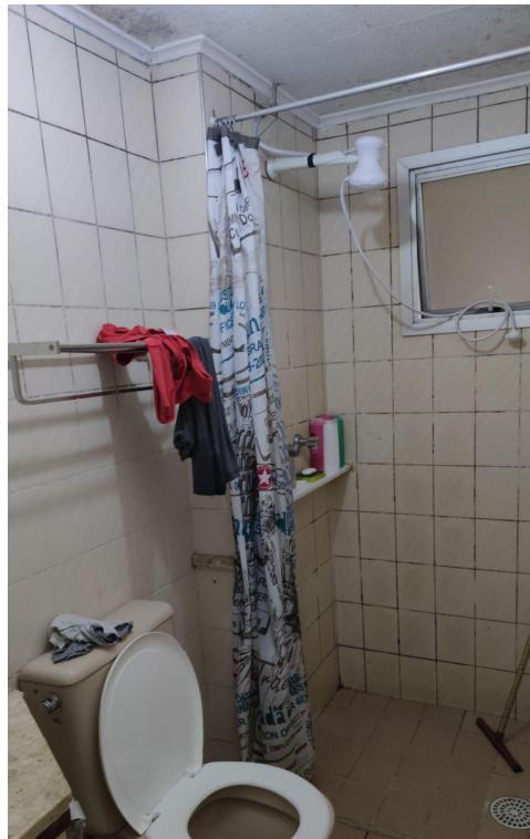
Figura 2: marcas de mofo no teto do banheiro
