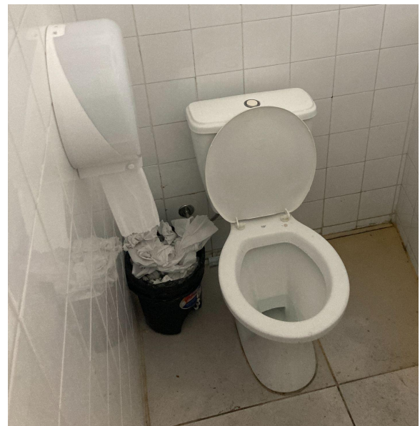
Figura 10: vaso sanitário sem assento
