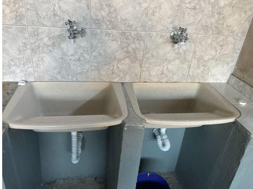
Figura 26: lavanderia com 2 tanques
