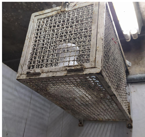
Figura 11: chuveiro com grade
