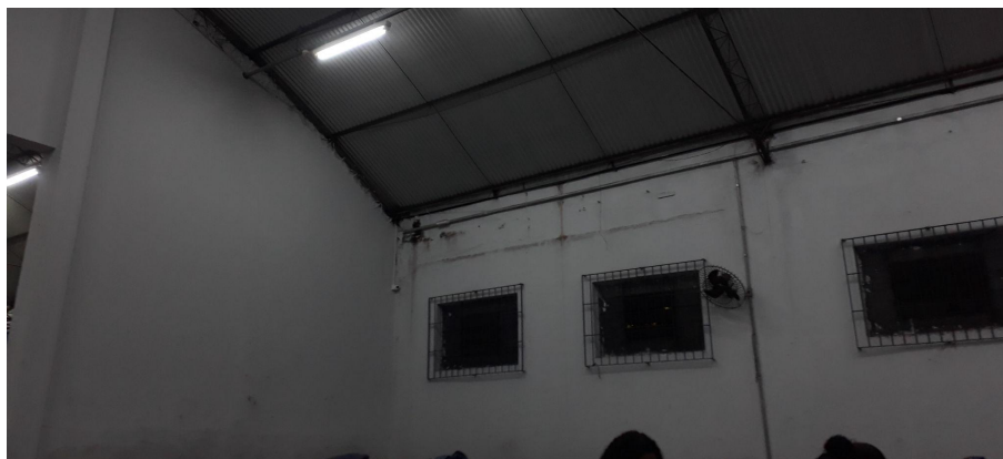
Figura 7: mancha de possível infiltração
