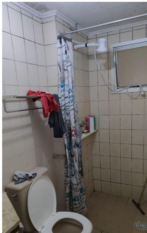
Figura 2: marcas de mofo no teto do banheiro
