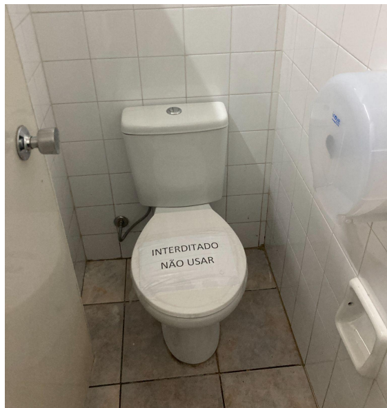
Figura 9: vaso sanitário interditado
