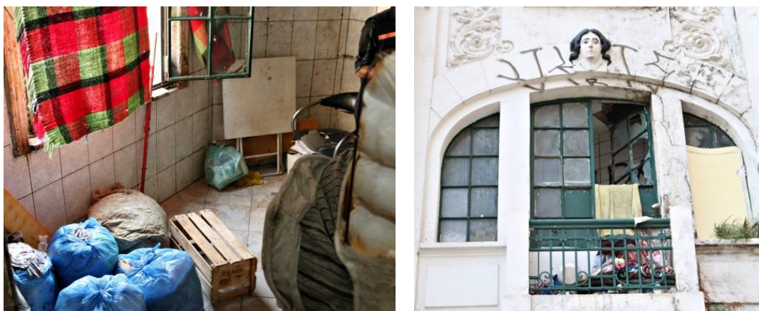
Figura 32 e 33: acúmulo de materiais nas áreas de circulação e nas janelas. Imagem extraída do relatório do COMDEC de 2021
