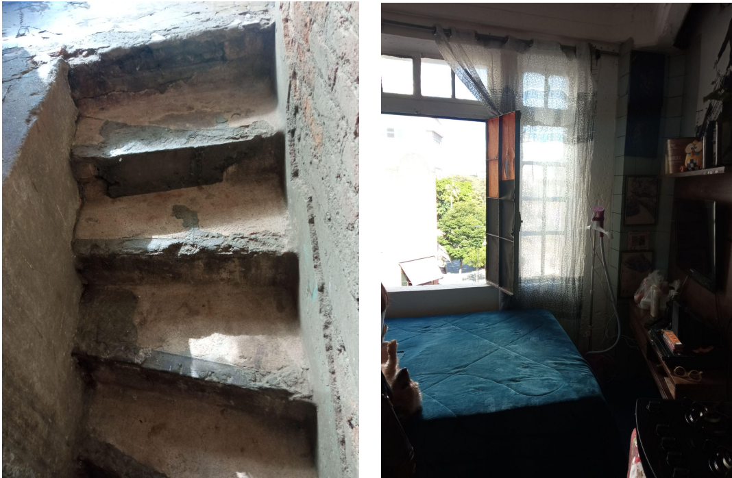
Figuras 20 e 21: à esquerda, escada sem revestimento em um dos pavimentos; à direita vista de uma das unidades, na qual é possível verificar amplitude das janelas e condições de iluminação e ventilação.
