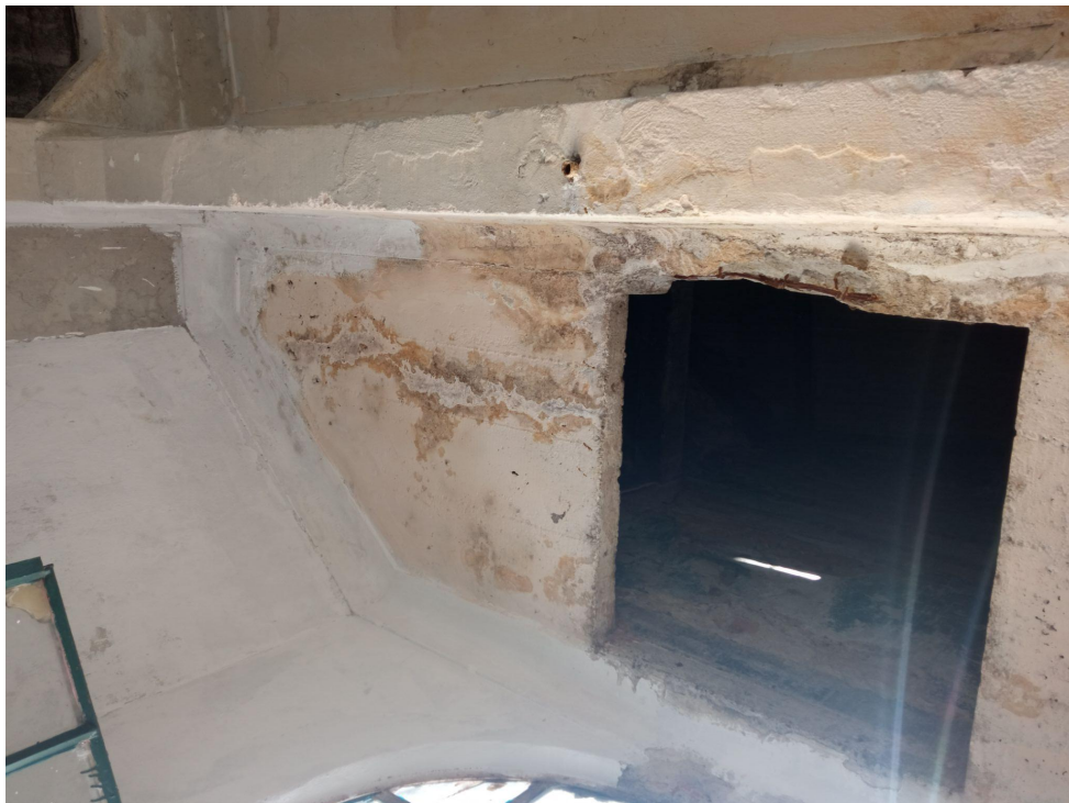
Figura 24: marcas de infiltração no último andar da edificação.
