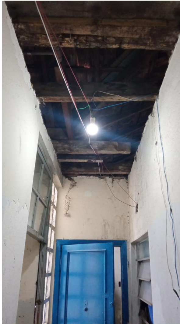
Figura 15: fiação elétrica exposta no segundo pavimento, sem forro.
