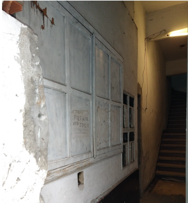
Figura 35: corredor de entrada da ocupação, onde se verifica ausência de corrimão nas escadas, caixas de forma vazias e sem extintor. Imagem extraída do relatório do COMDEC de 2021
