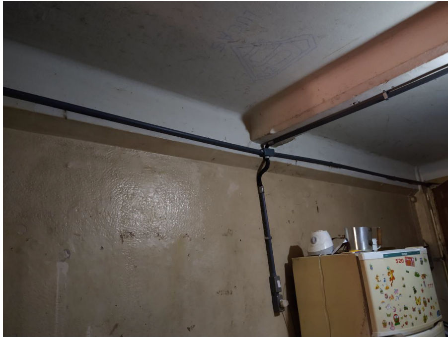
Figura 25: Fios elétricos acomodados em eletrodutos. Imagem extraída do relatório do COMDEC de 2021
