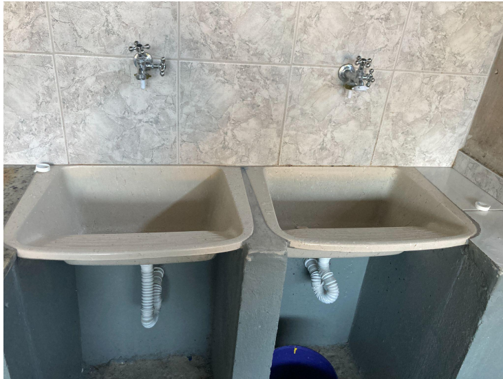
Figura 26: lavanderia com 2 tanques
