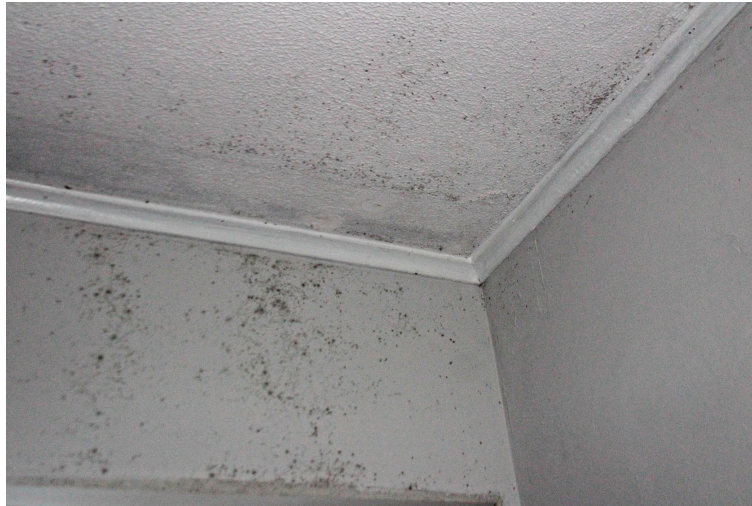
Figura 1: marcas de mofo na parede e no teto do quarto
