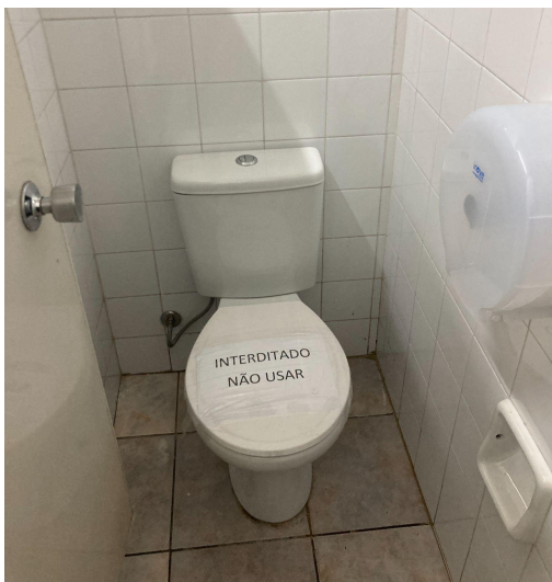
Figura 9: vaso sanitário interditado
