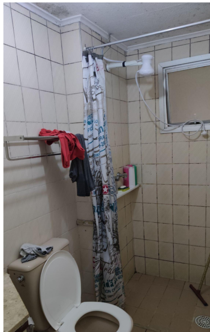
Figura 2: marcas de mofo no teto do banheiro
