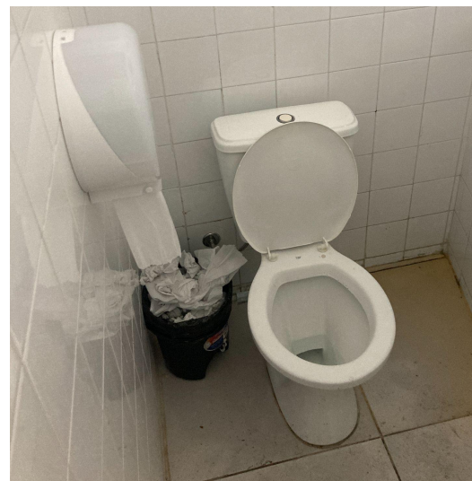
Figura 10: vaso sanitário sem assento
