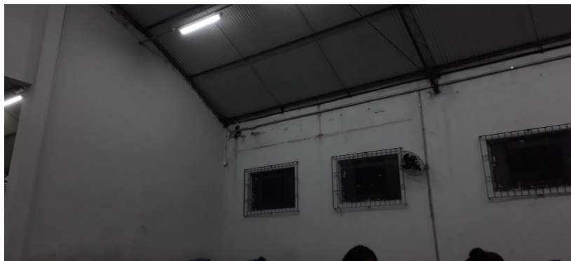
Figura 7: mancha de possível infiltração
