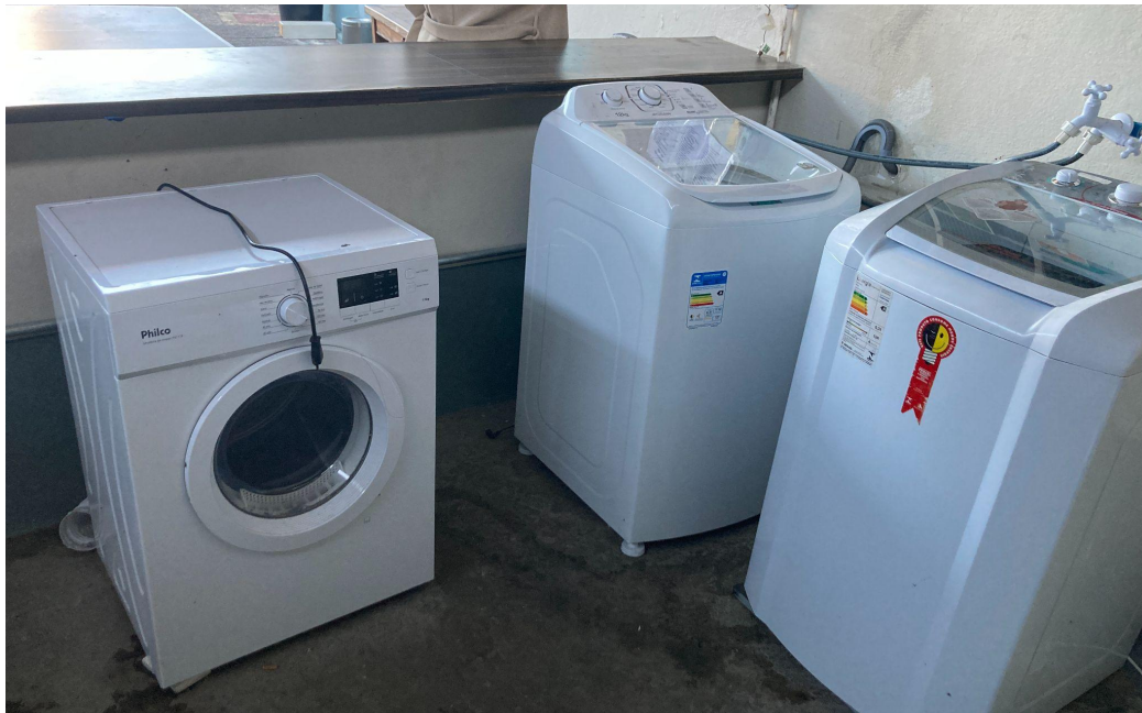
Figura 25: lavanderia - 2 máquinas de lavar e 1 de secar
